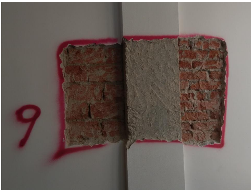
Slika 7.15 Sondažna bušotina 9 – "Kant zid" od pune opeke, armiranobetonski stup i zid od pune opeke
