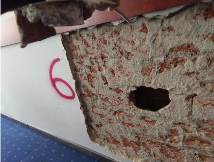
Slika 7.12 Sondažna bušotina 6 – "Kant zid" od pune opeke - rupa od utičnice
