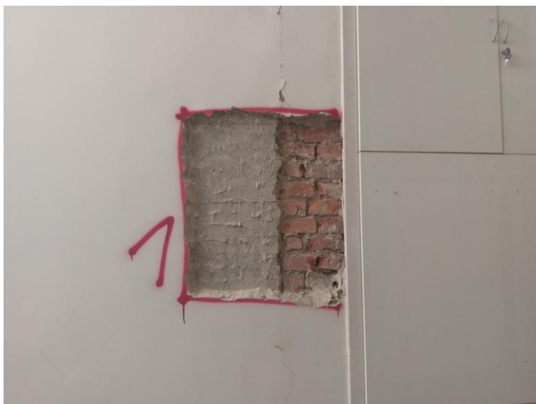
Slika 7.2 Sondažna bušotina 1 – Armiranobetonski stup uz zid od pune opeke - pukotina po vertikalnim sljubnicama
