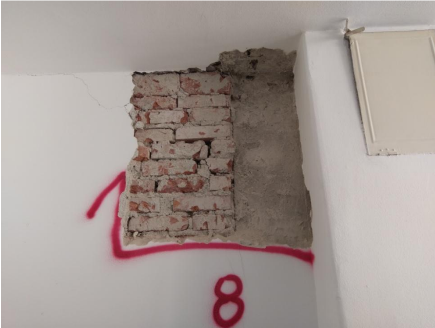
Slika 7.14 Sondažna bušotina 8 – Zid od pune opeke uz armiranobetonski stup - odvajanje vertikalnih sljubnica
